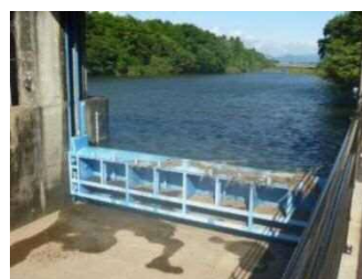
第三頭首工の泥吐け
